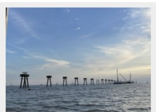
NHÀ MÁY ĐIỆN GIÓ ĐÔNG HẢI 1 DONG HAI 1 WIND POWER PLANT
