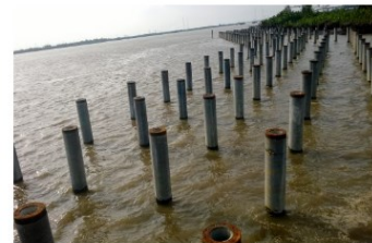
KÈ BẾN CẤP TÀU 2000DWT NHON TRẠCH ĐỒNG NAI NHON TRACH EMBANKMENT
